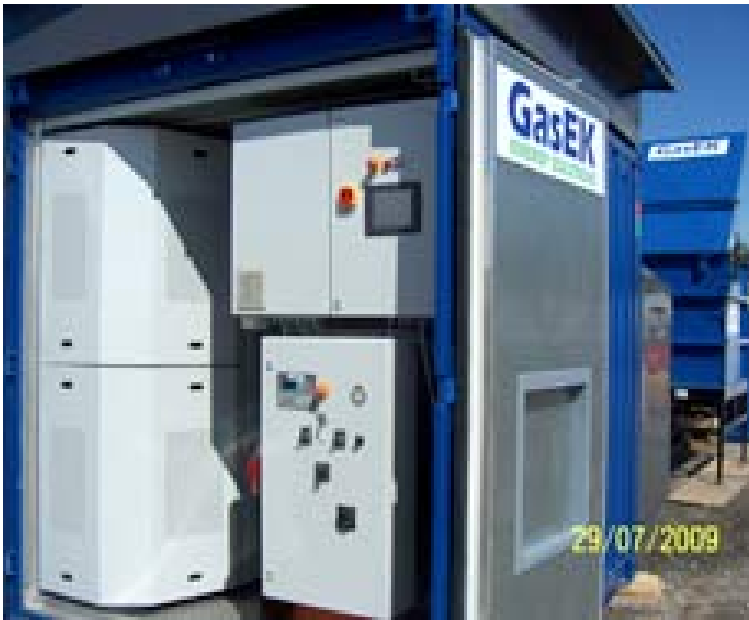
GasEK Oy:n 150kW voimalakontti, joka tuottaa 50kW sähköä ja 100kW lämpöä
